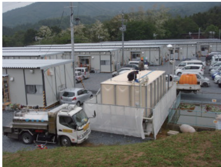
仮設住宅に設置された FRP 製給水タンク 給水車から給水タンクに給水している
